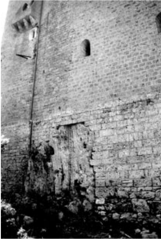
Figura 7. Lato orientale dell'Abbazia con evidenziata la lesione verticale in corrispondenza di uno sperone di travertino situato alla base del muro.
